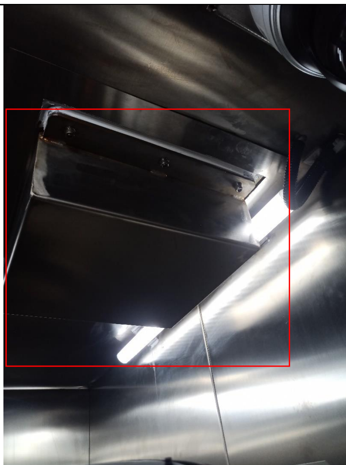
图3-5本项目探伤铅房机械排风口（带防护罩）
