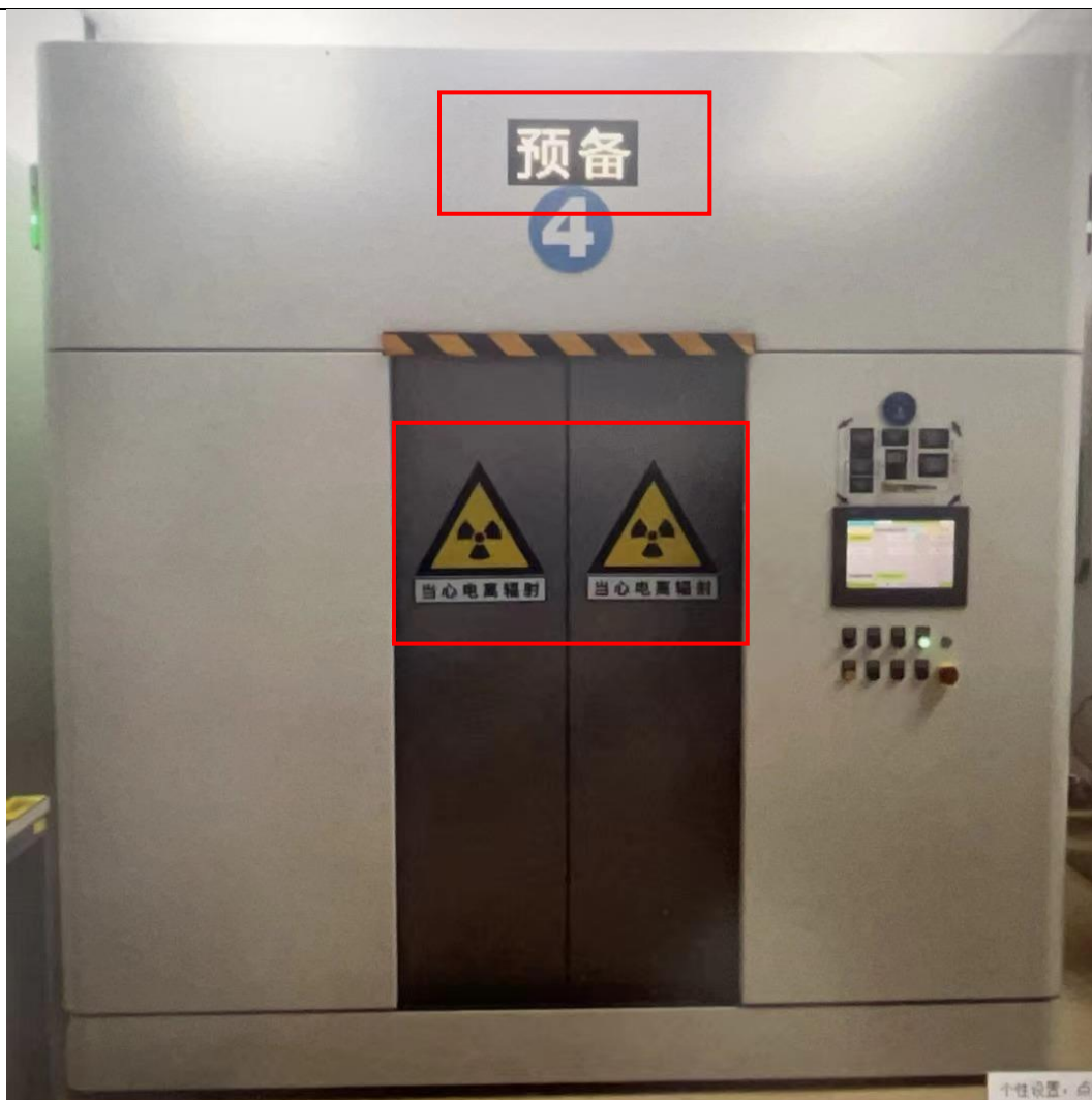
图3-2 本项目探伤铅房状态指示灯和电离辐射警告标志
