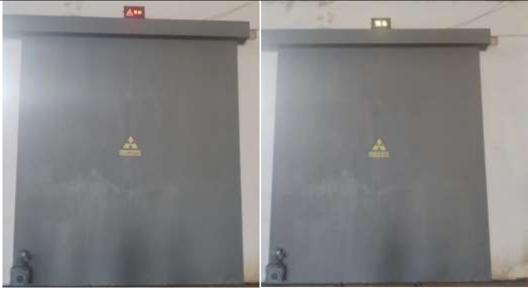
(b) 防护大门处电离辐射警告标志及工作指示灯
