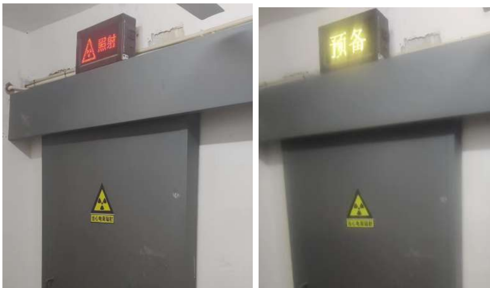
(a) 联锁门处电离辐射警告标志及工作指示灯
