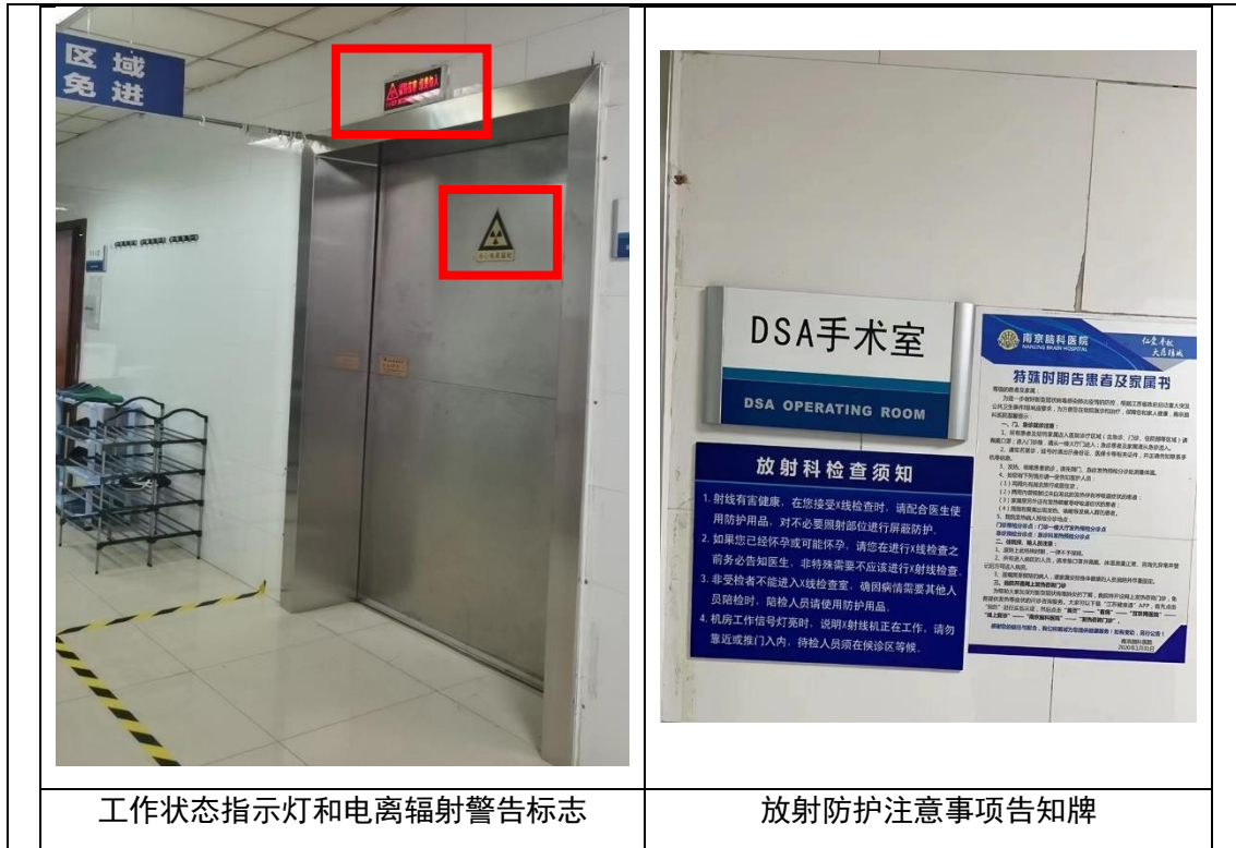
图3-2 本项目DSA机房工作状态指示灯、电离辐射警告标志及放射防护注意事项告知牌 (2) 闭门和防夹装置
