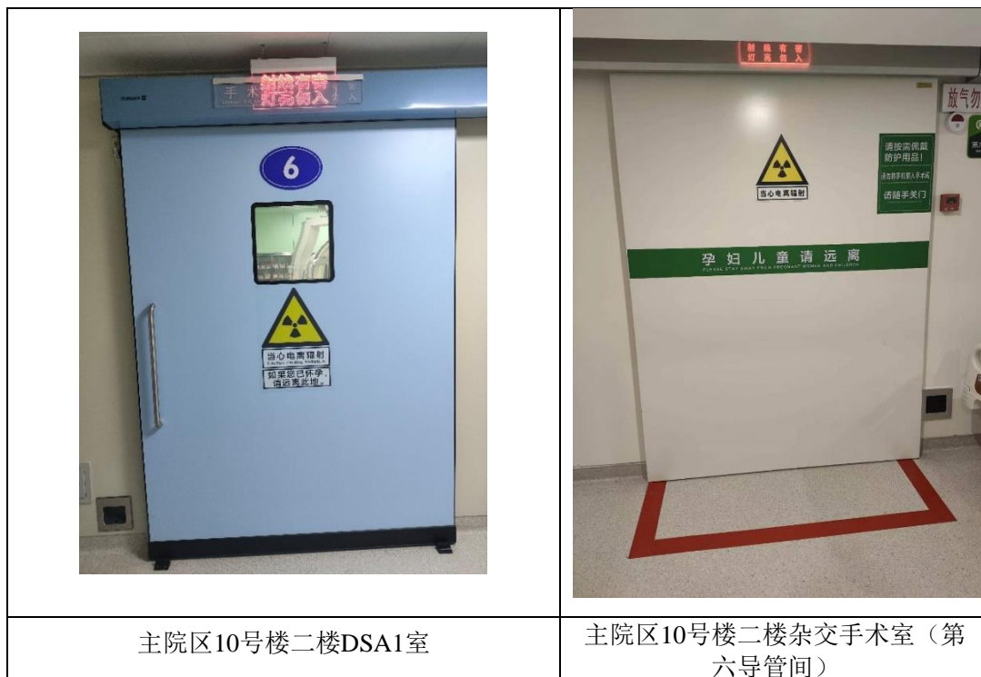
图3-2 本项目DSA机房工作状态指示灯和电离辐射警告标志
