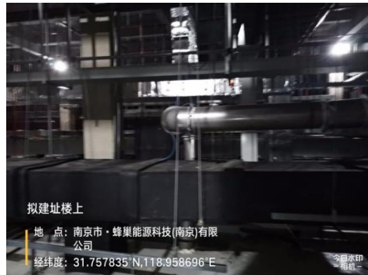
图 8-6 项目拟建址（测试车间）楼上设备层
