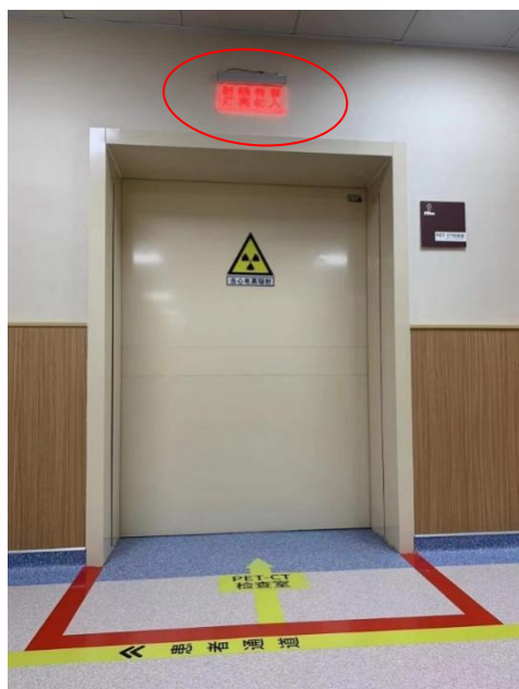
防护门关闭状态
