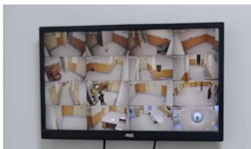
控制室内视频监视器
