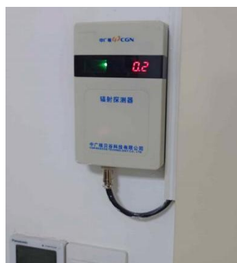
固定式辐射监测系统探头
