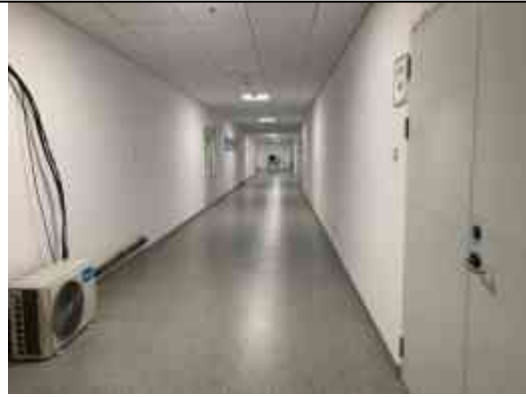
(f) 上方净化机房
