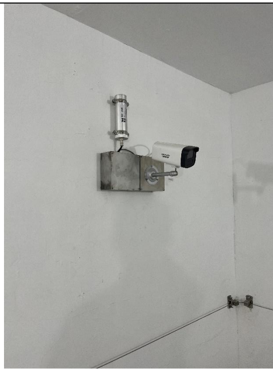
3#加速器机房主机室摄像头
