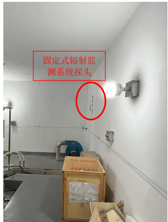
2#加速器机房主机室内
