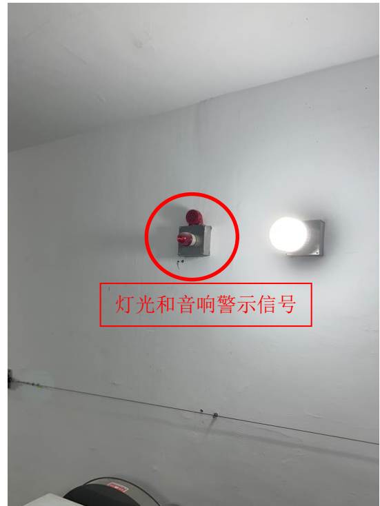
2#加速器机房主机室内
