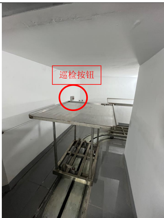
1#加速器机房辐照小车出口迷道巡检按钮
