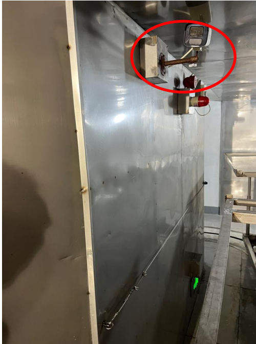
1#加速器机房辐照室摄像头
