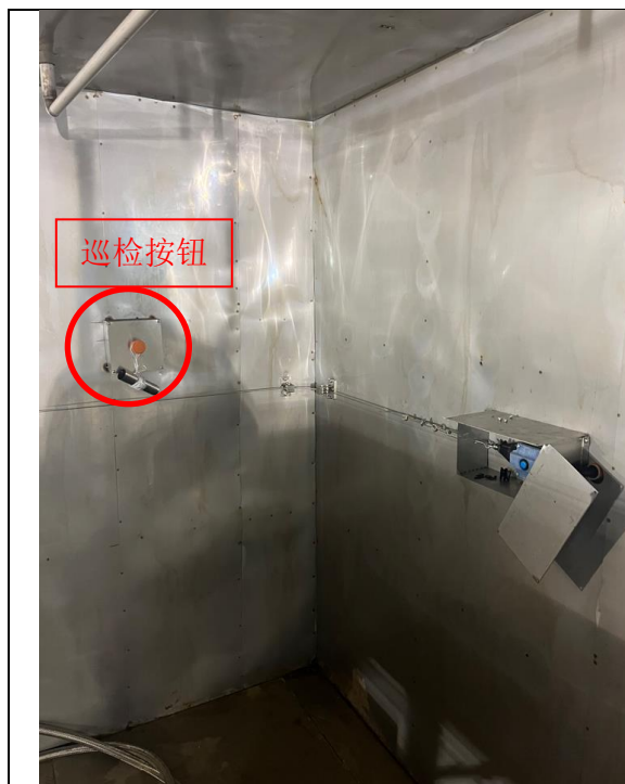
2#加速器机房辐照室内巡检按钮
