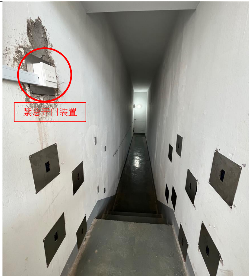
1#加速器机房主机室防护门处紧急开门装置
