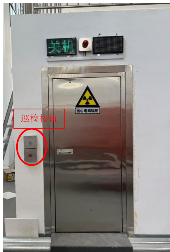
3#加速器机房主机室门口巡检按钮
