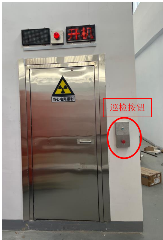
2#加速器机房主机室门口巡检按钮
