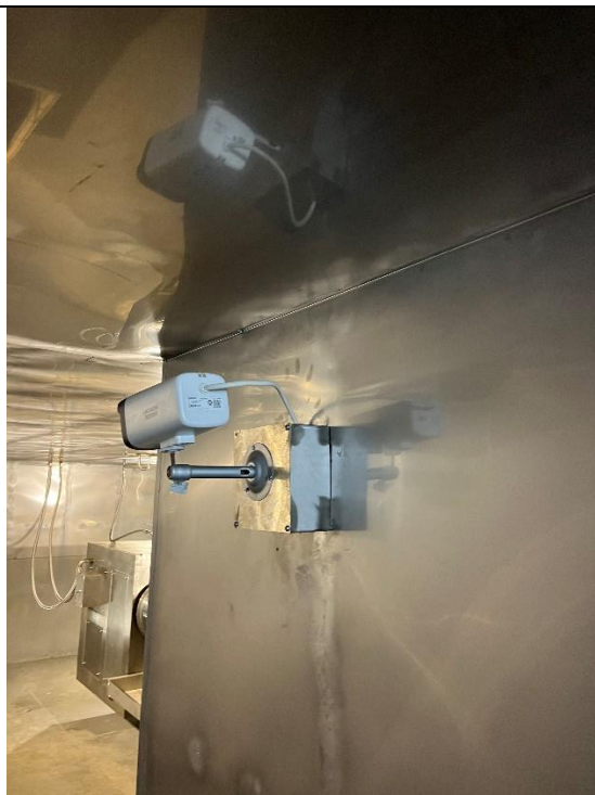
3#加速器机房辐照室摄像头
