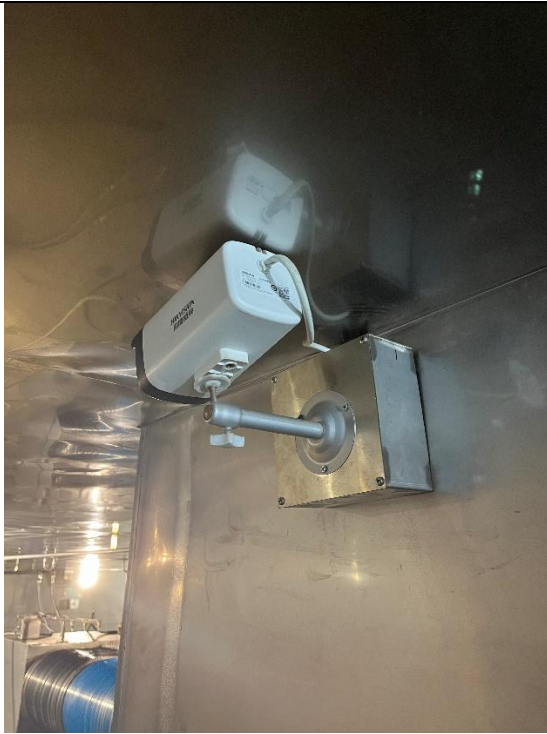
2#加速器机房辐照室摄像头
