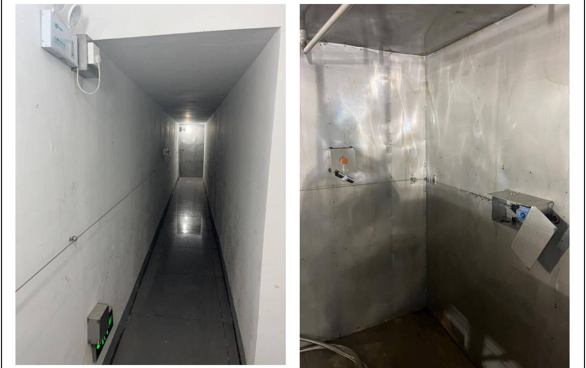
2#加速器机房辐照室拉线开关
