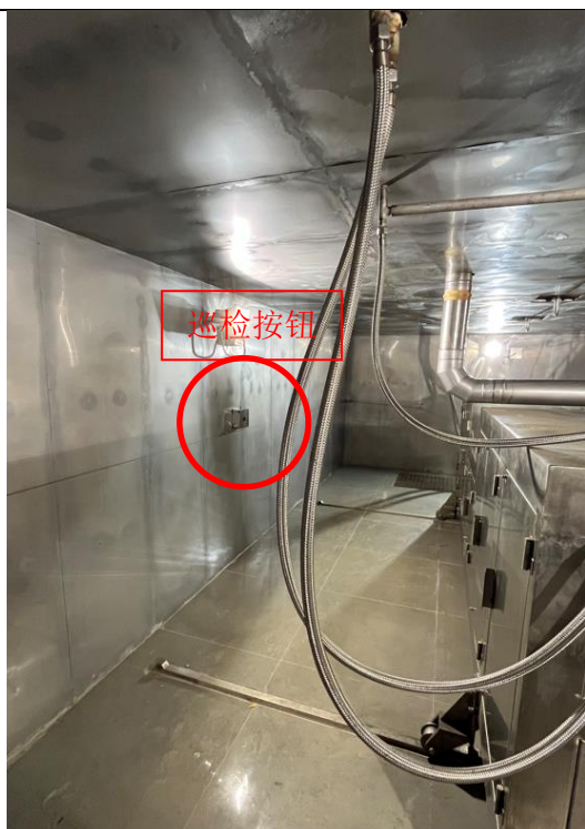
3#加速器机房辐照室内巡检按钮
