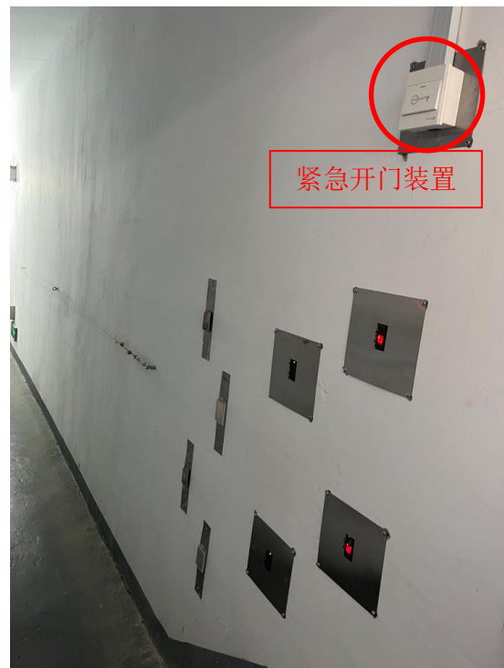
2#加速器机房主机室防护门处紧急开门装置
