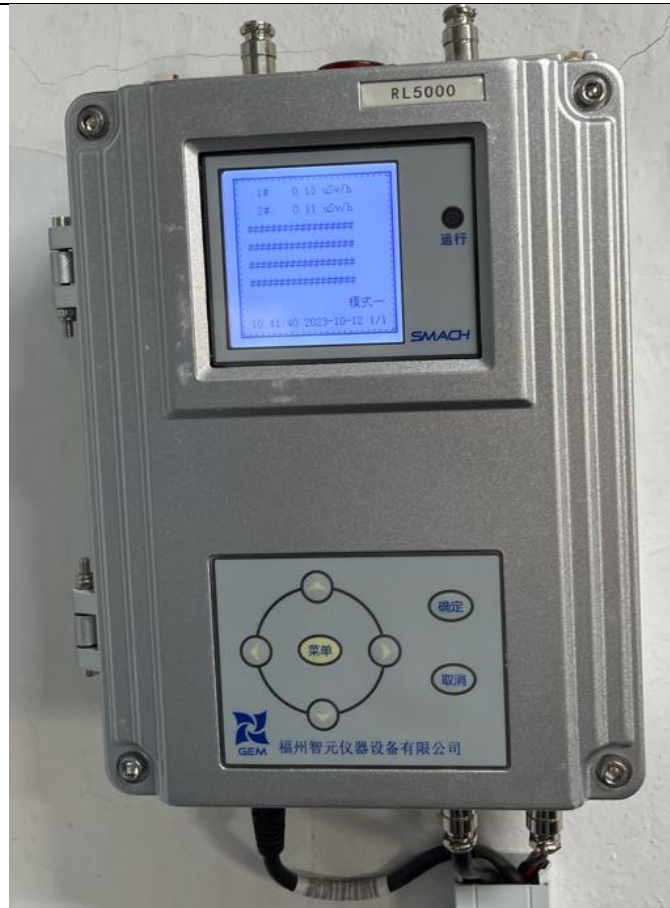
3#加速器机房固定式辐射监测系统显示面板
