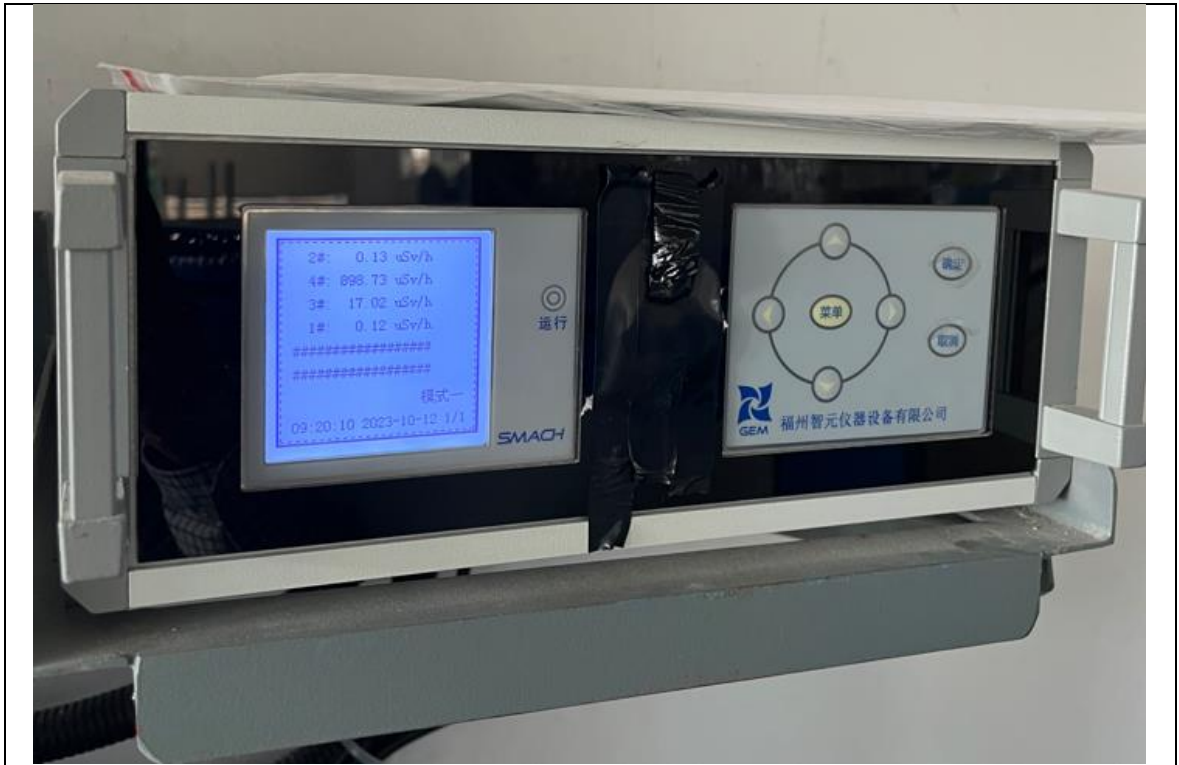
1#加速器机房固定式辐射监测系统显示面板
