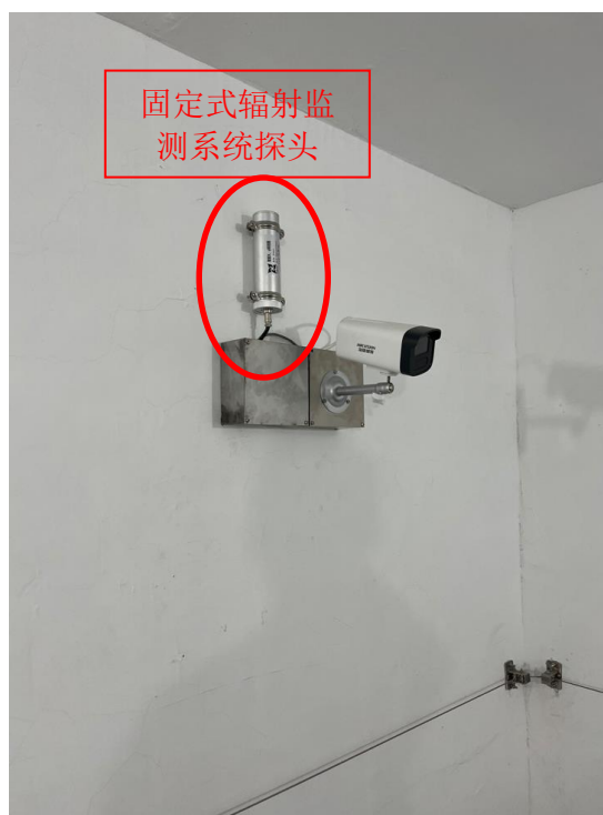
3#加速器机房主机室内
