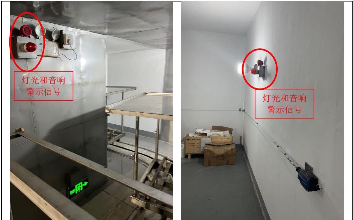
1#加速器机房辐照室内
