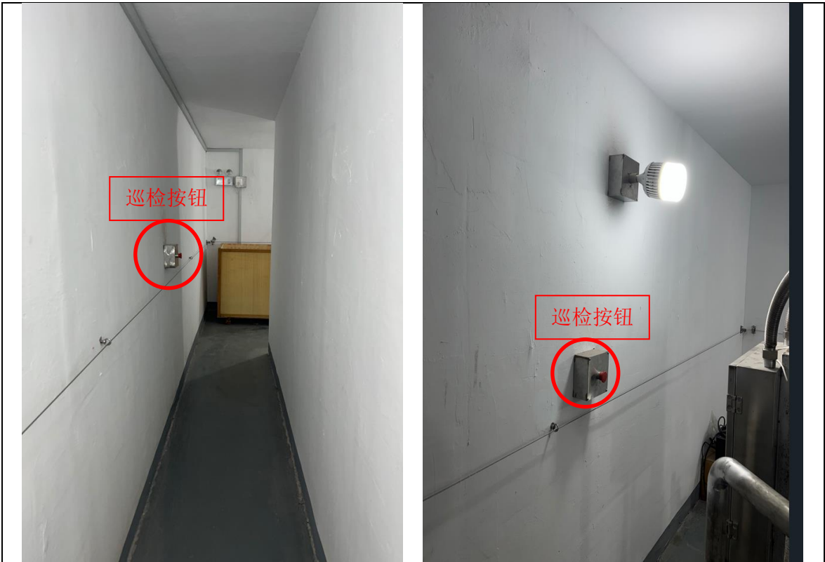
3#加速器机房主机室迷道巡检按钮
