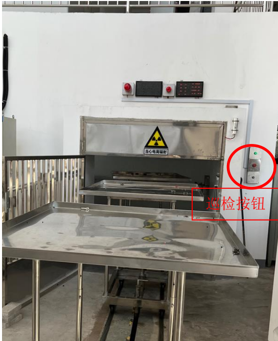
1#加速器机房辐照小车进口处巡检按钮
