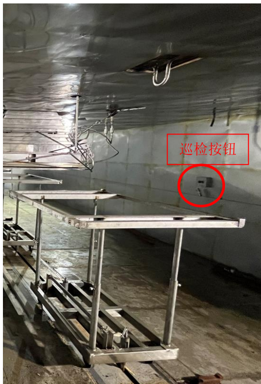
1#加速器机房辐照室内巡检按钮
