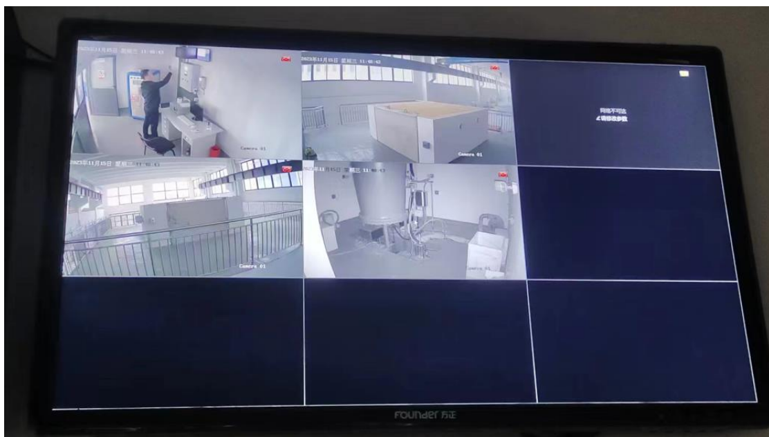
3#加速器机房控制室内监控电视
