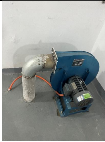
2#加速器机房主机室风机
