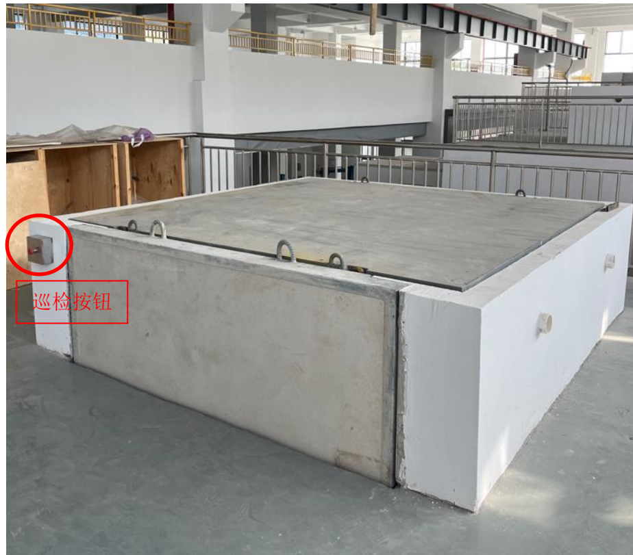
3#加速器机房三层主机室外巡检按钮
