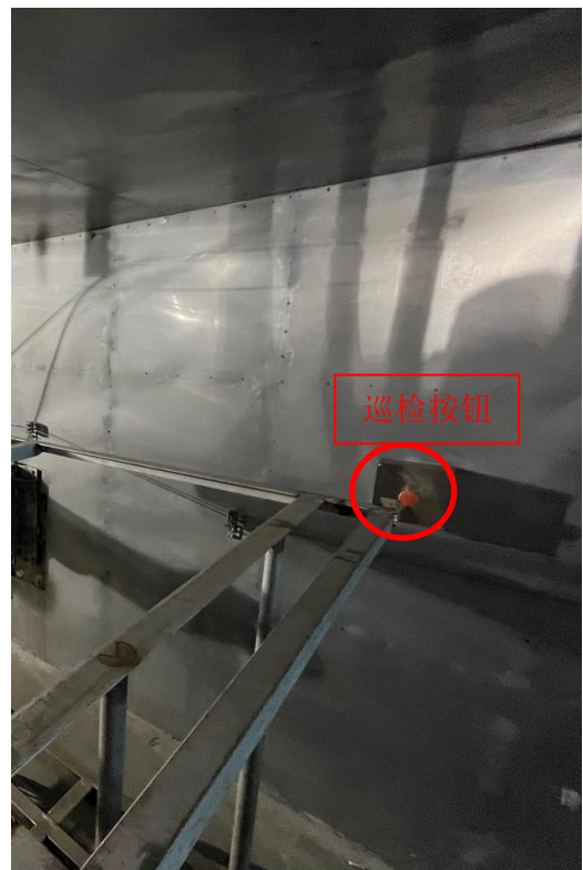
1#加速器机房辐照室内巡检按钮
