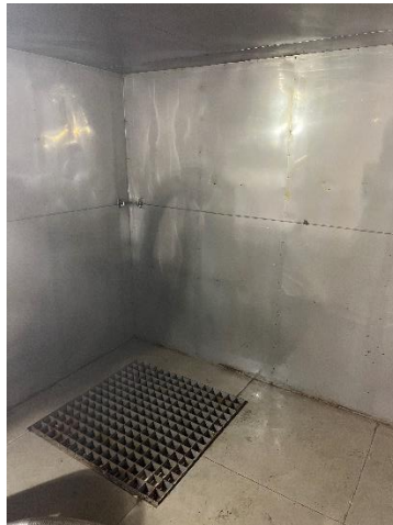
2#加速器机房辐照室排风口
