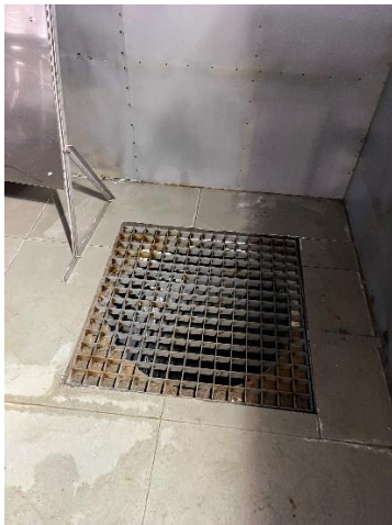
1#加速器机房辐照室排风口
