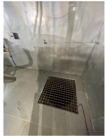
3#加速器机房辐照室排风口
