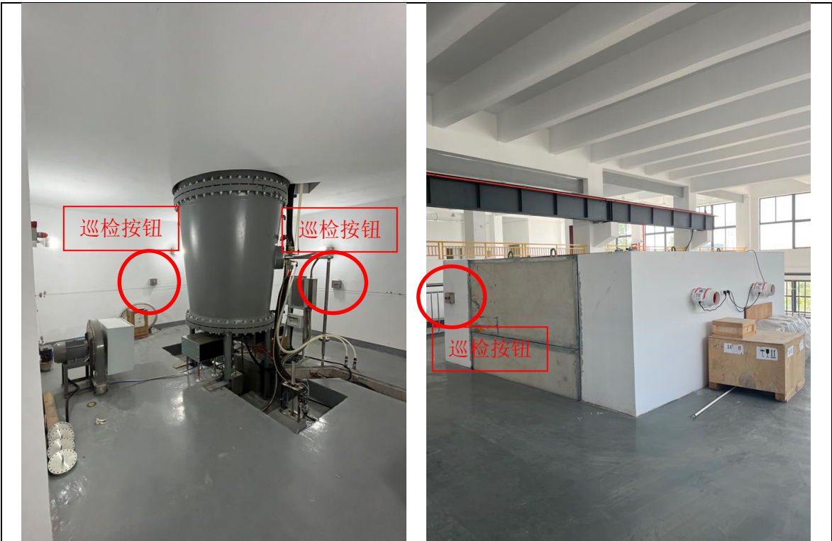
2#加速器机房主机室内巡检按钮
