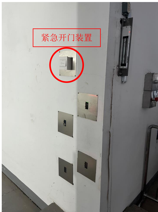
2#加速器机房辐照室防护门处紧急开门装置
