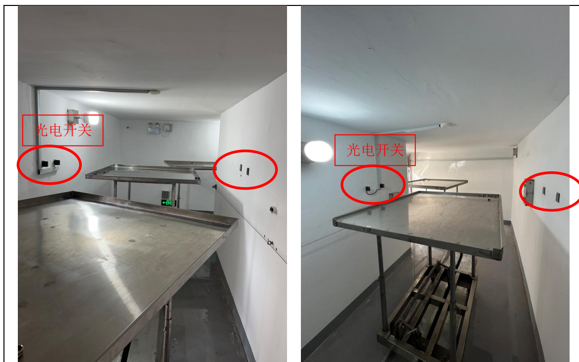
1#加速器机房辐照室入口迷道2道光电开关
