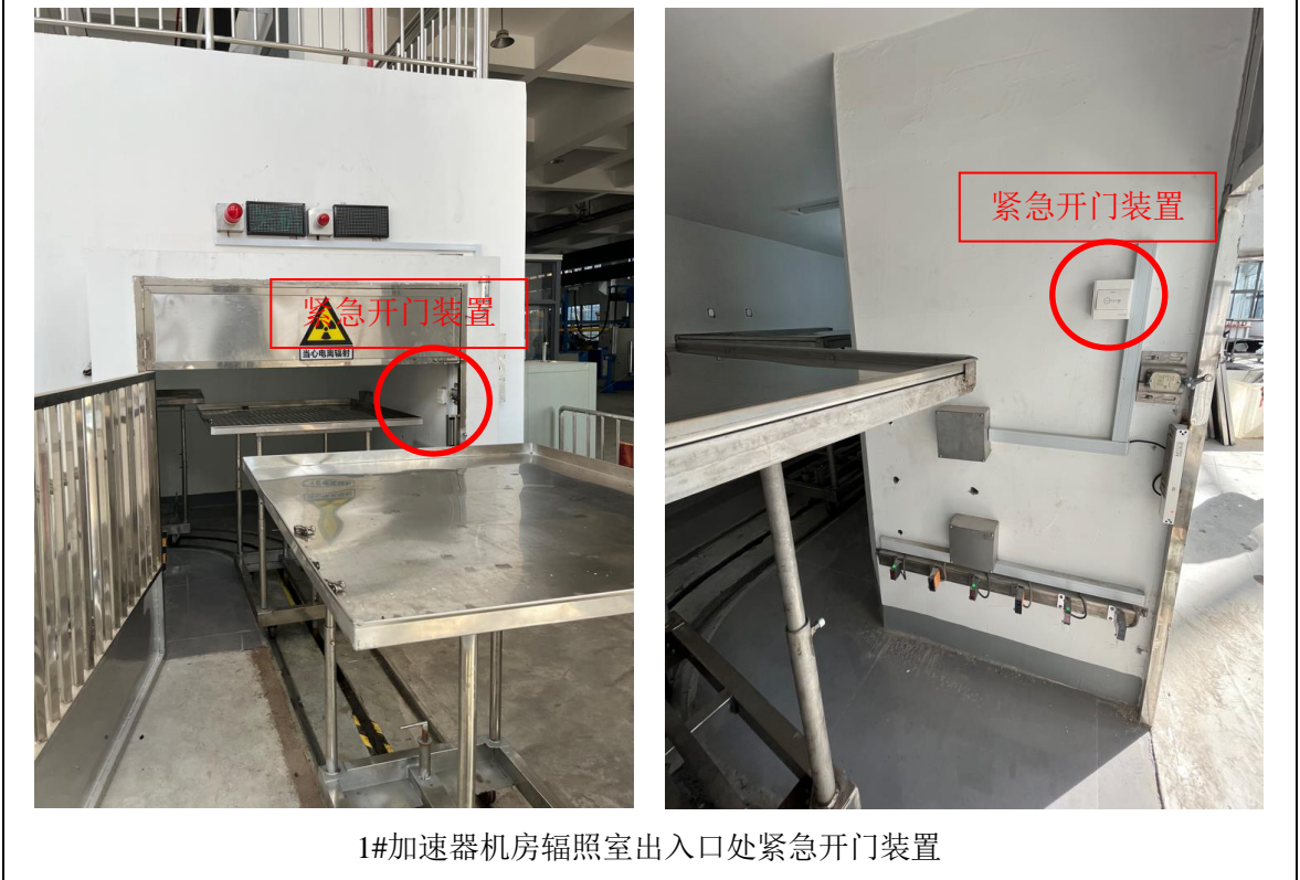
图3-25 加速器机房拉线开关
