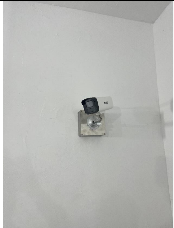
2#加速器机房主机室摄像头
