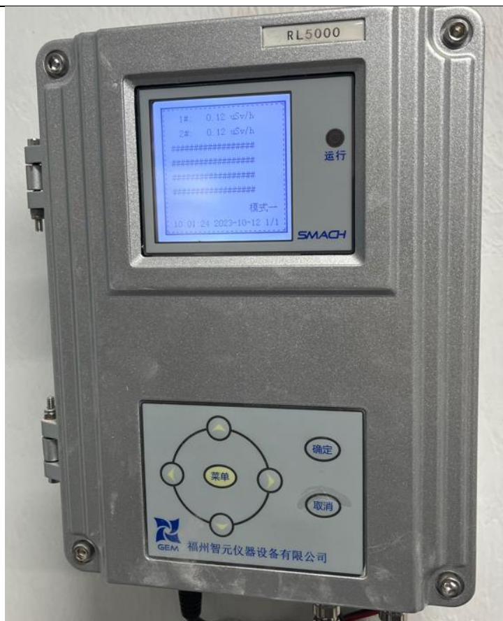
2#加速器机房固定式辐射监测系统显示面板
