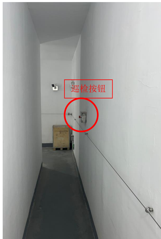
2#加速器机房主机室迷道巡检按钮
