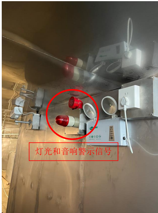
2#加速器机房辐照室内
