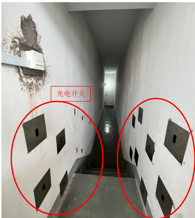
图3-20 1#加速器机房主机室4道光电开关
