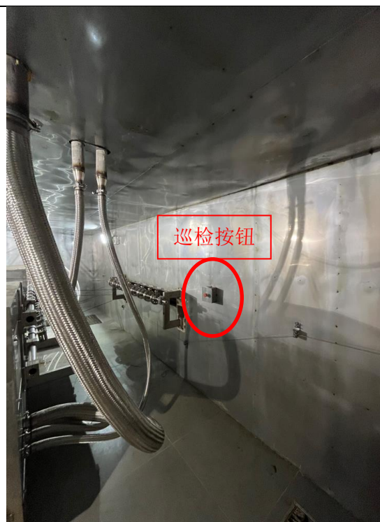
3#加速器机房辐照室内巡检按钮
