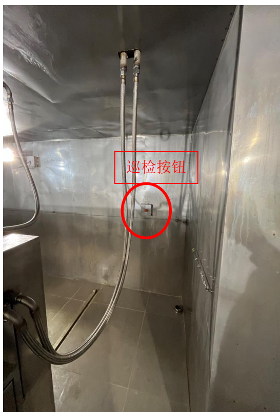
3#加速器机房辐照室内巡检按钮
