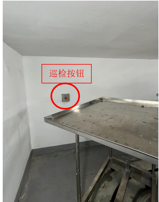
1#加速器机房辐照小车进口迷道巡检按钮
