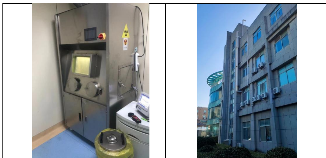
图 3-8 PET/CT 工作场所现场通风橱及放疗楼室外排风管道图
