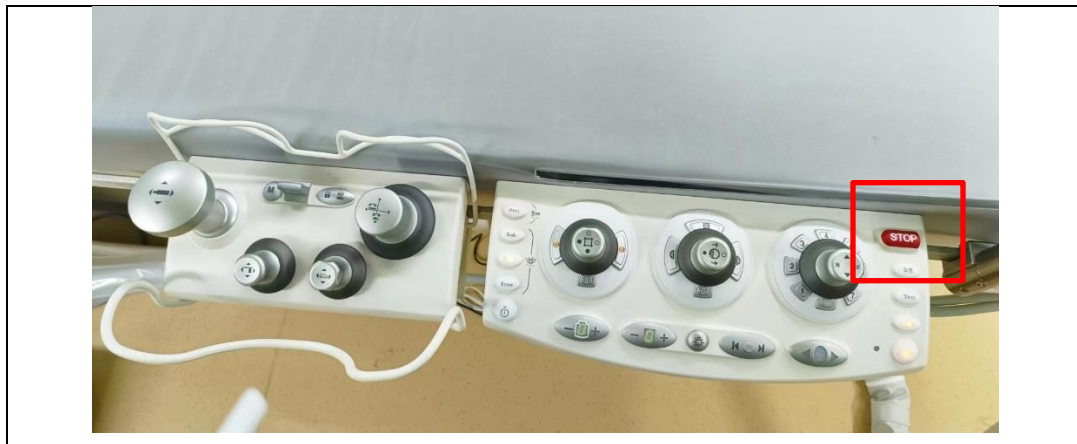
图3-4 DSA机房内的急停按钮
