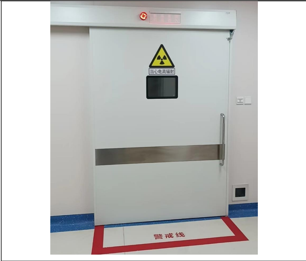
图3-2 本项目DSA机房工作状态指示灯和电离辐射警告标志
