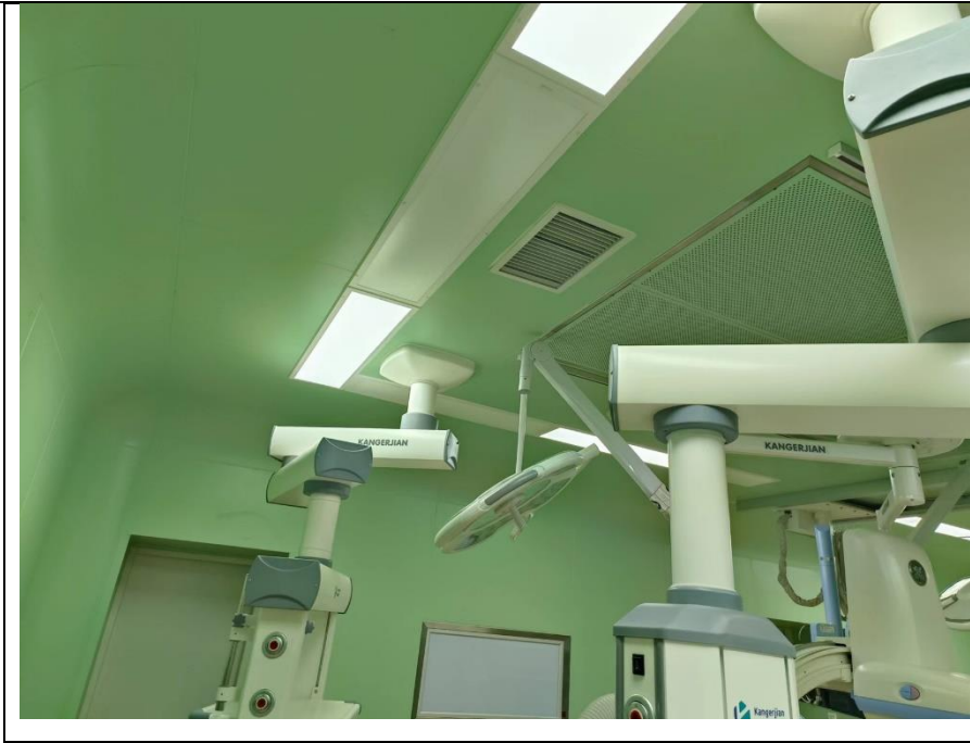
图 3-6 本项目 DSA 机房通风系统
