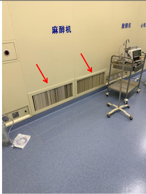
一期住院楼三楼DSA室
