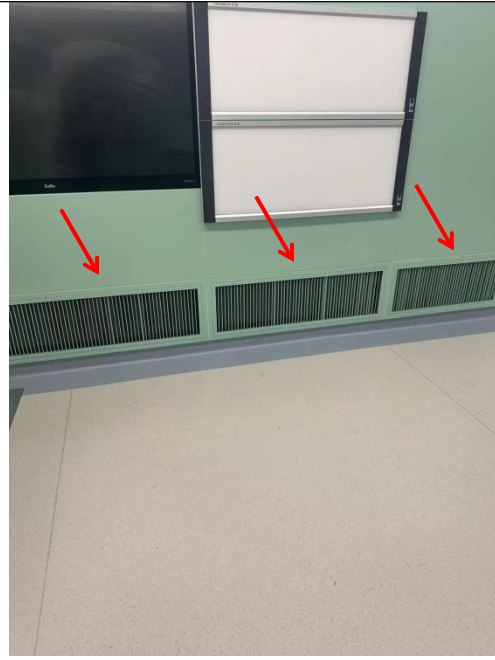
二期医技楼三楼杂交手术室
