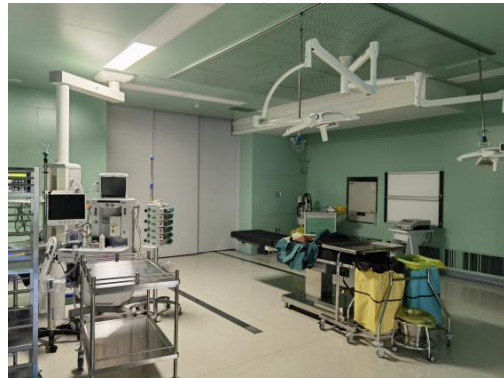
二期医技楼三楼杂交手术室南侧CT存放间
