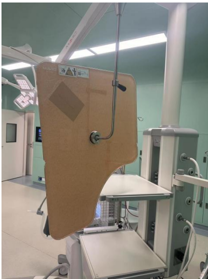
二期医技楼三楼杂交手术室悬挂铅屏风
