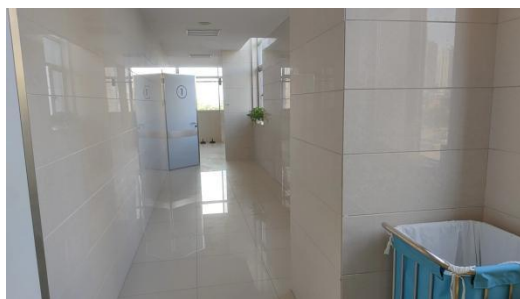
一期住院楼三楼DSA室东侧空调净化机房
