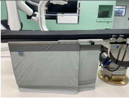
二期医技楼三楼杂交手术室床侧防护铅帘
