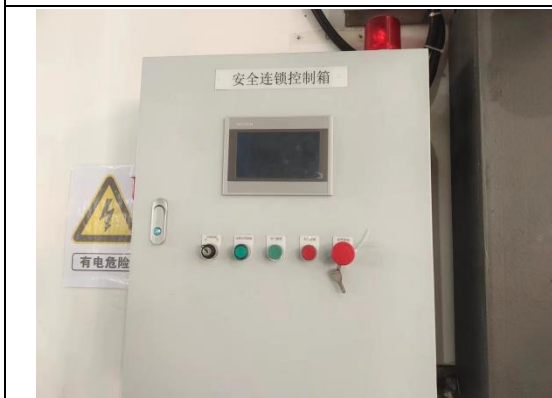
图3-6 本项目巡检按钮和巡检装置
