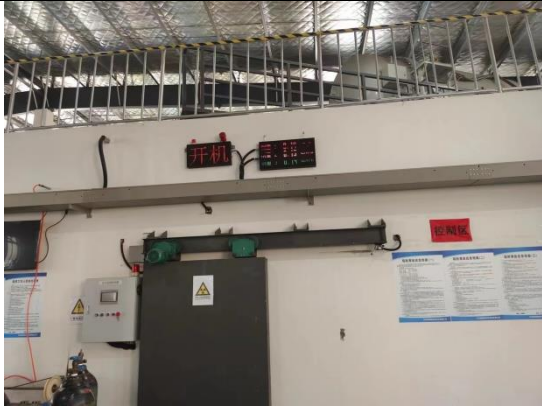
图3-2 本项目加速器辐照室现场正面图及控制区标识
