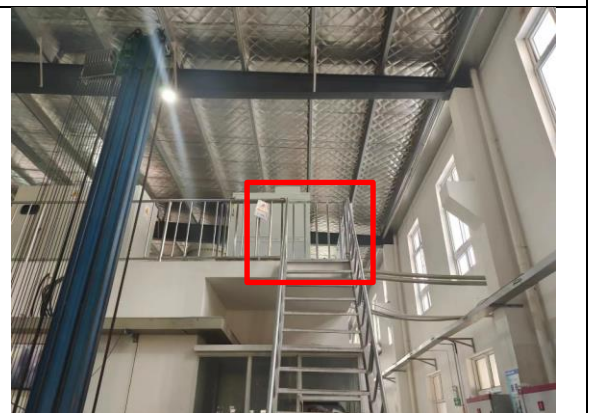
图3-11 本项目辐照室二楼入口处门禁
