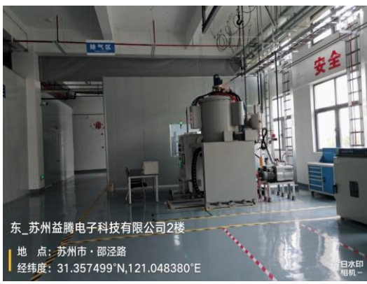
图 8-5 厂房 2 楼 2#调试区东侧 (工序台)
