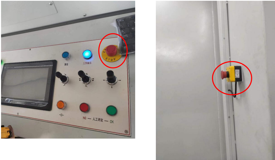
图3-5 调试铅房及XR225型X射线检测装置的急停按钮
