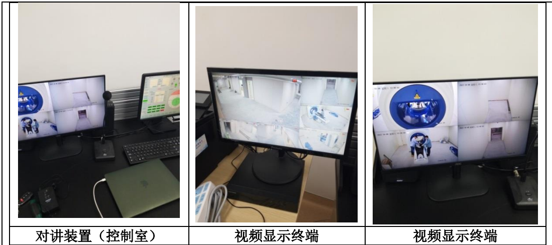
图 3-7 本项目陀螺刀机房监控装置、监控显示终端和对讲装置现场验证照片
