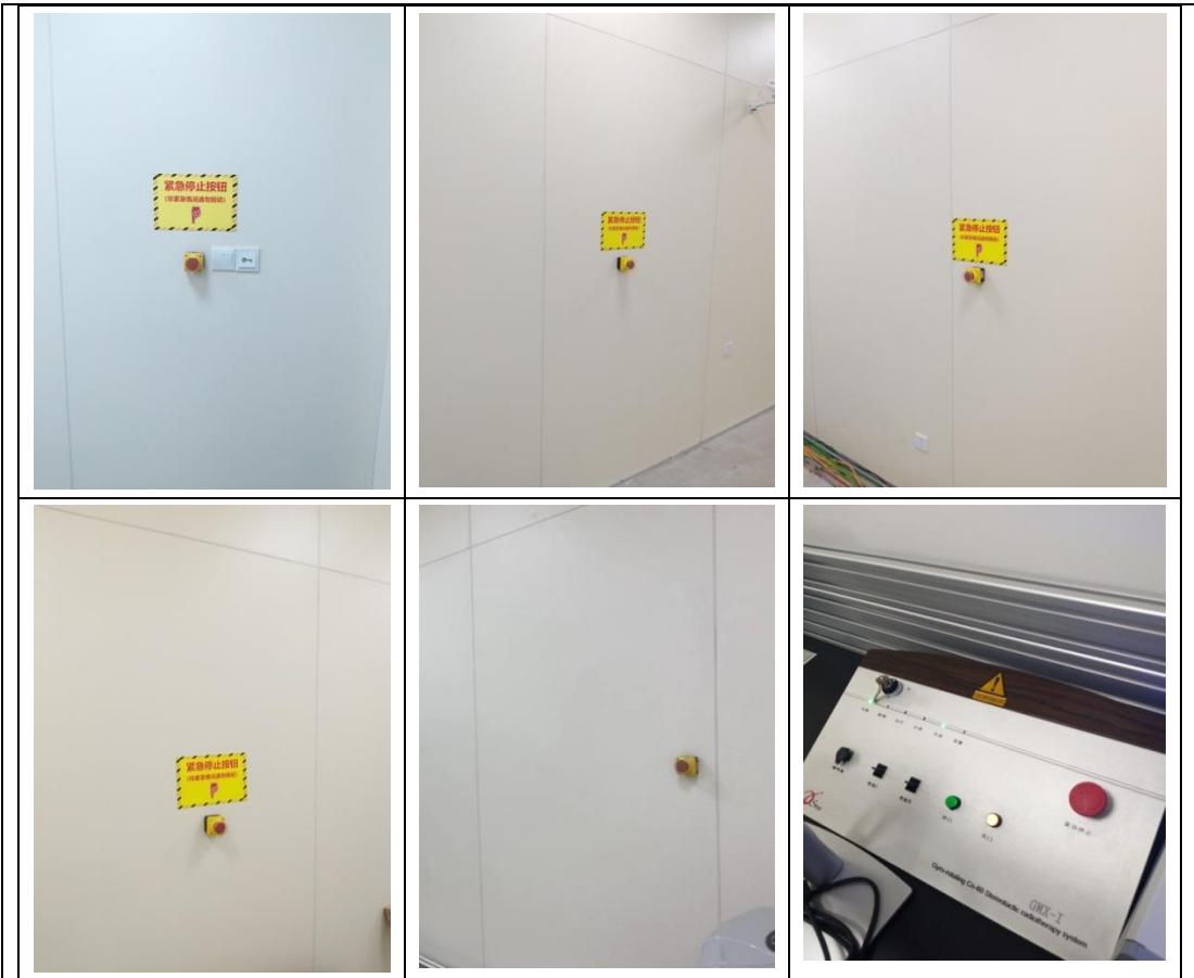
图3-9 本项目陀螺刀机房急停开关现场验证照片
