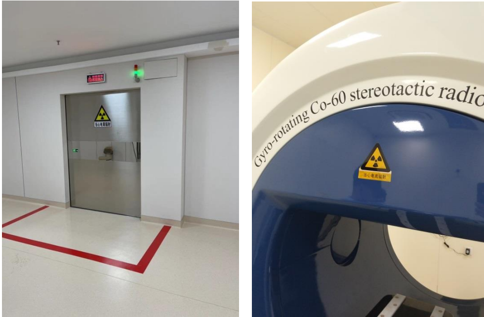
图3-5 本项目陀螺刀机房工作状态指示灯和电离辐射警告标志
