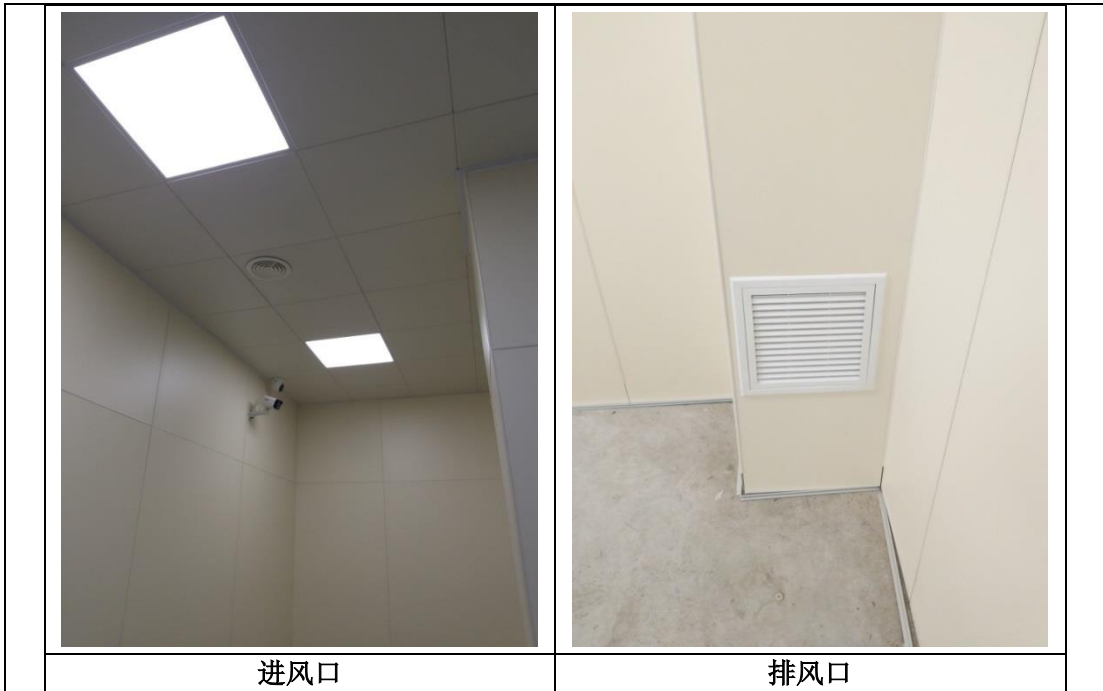
图 3-12 本项目陀螺刀机房进风口和排风口示现场验证照片
