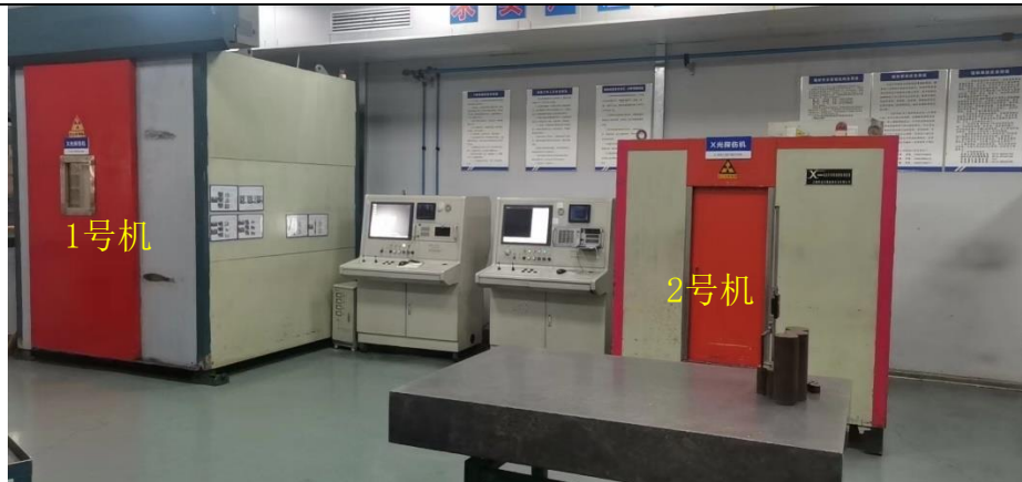
图3-2本项目无损检测室现场图
