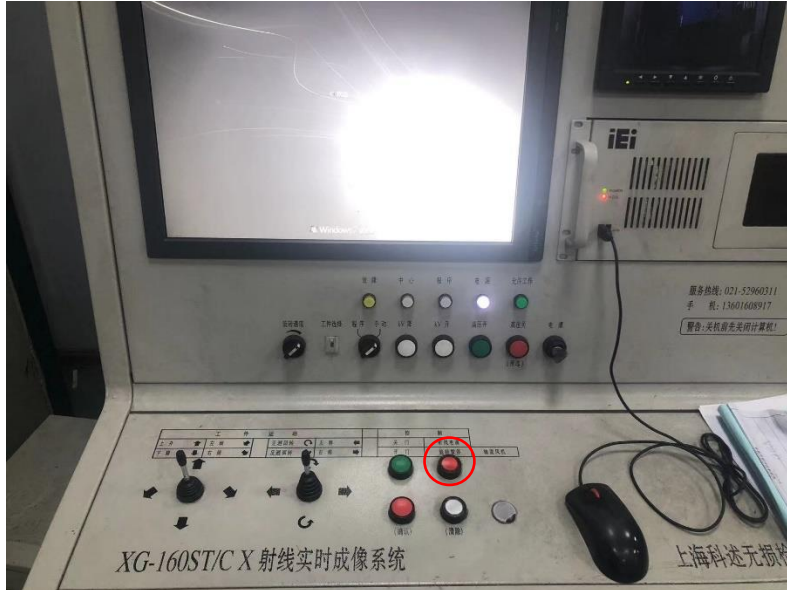
图3-4 X射线实时成像检测装置操作台设置急停按钮
