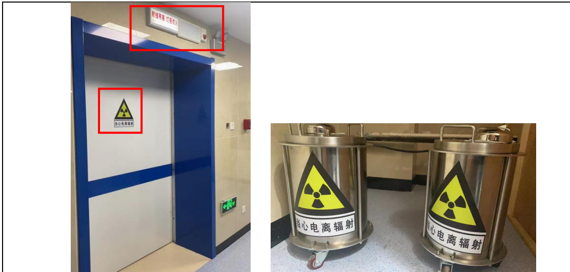
图3-2 本项目核医学工作场所工作状态指示灯和电离辐射警告标志
