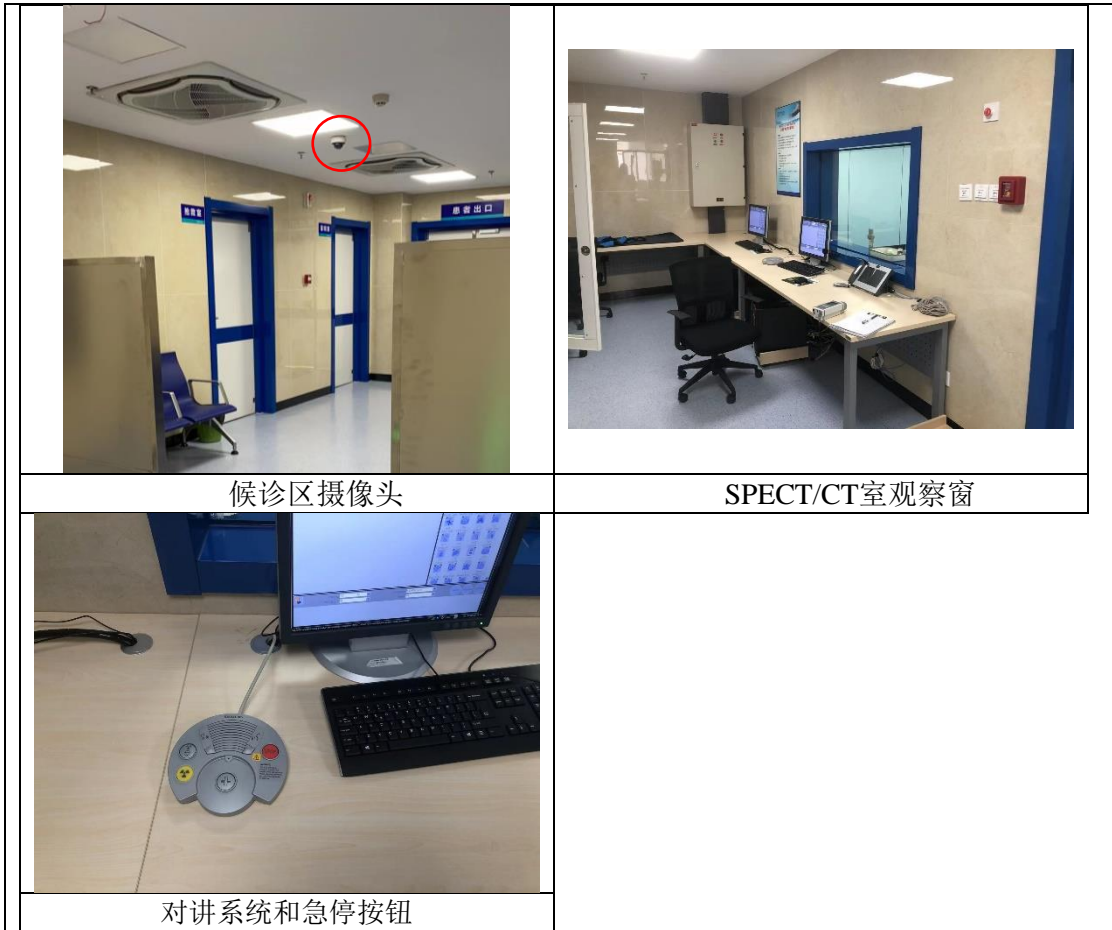
图3-3 本项目核医学工作场所影像监控装置、摄像头及对讲系统
