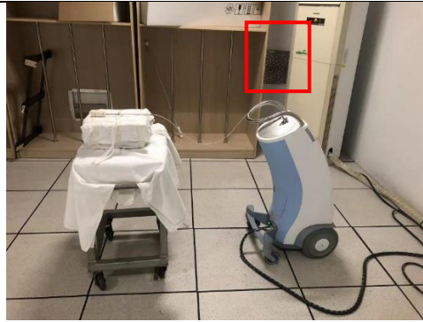
后装机房排风口
