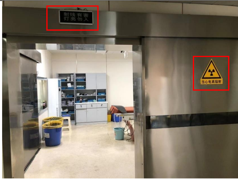
图3-8 1号楼四层DSA室工作状态指示灯和电离辐射警告标志
