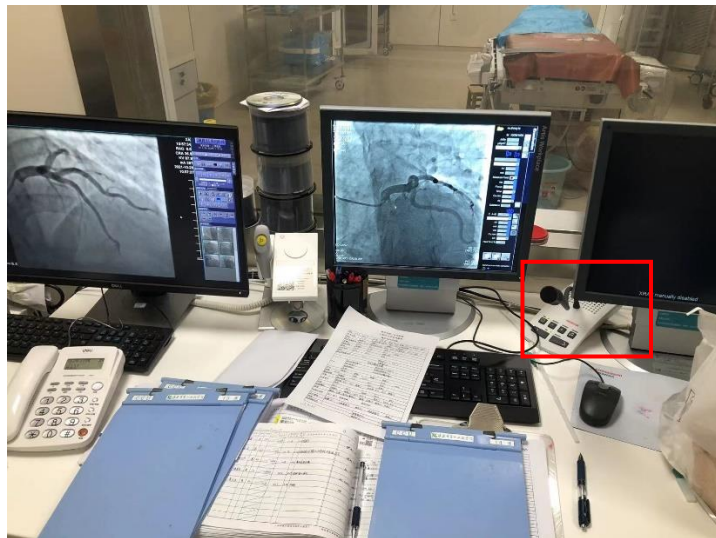
图3-12 1号楼四层DSA室观察窗及对讲装置
