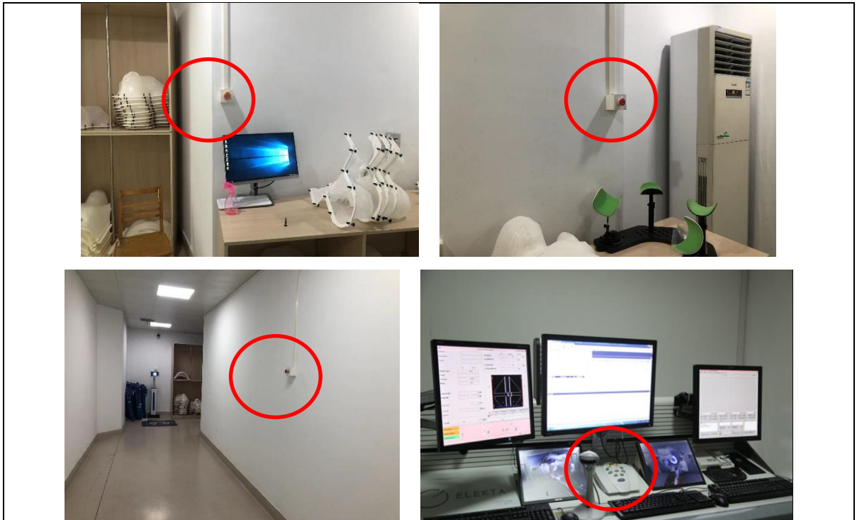
图3-17 加速器治疗室和控制室急停开关
