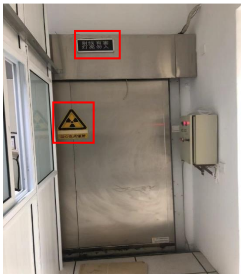
图3-7 后装机房工作状态指示灯和电离辐射警告标志
