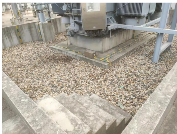
图 8-1 主变下方事故油坑
