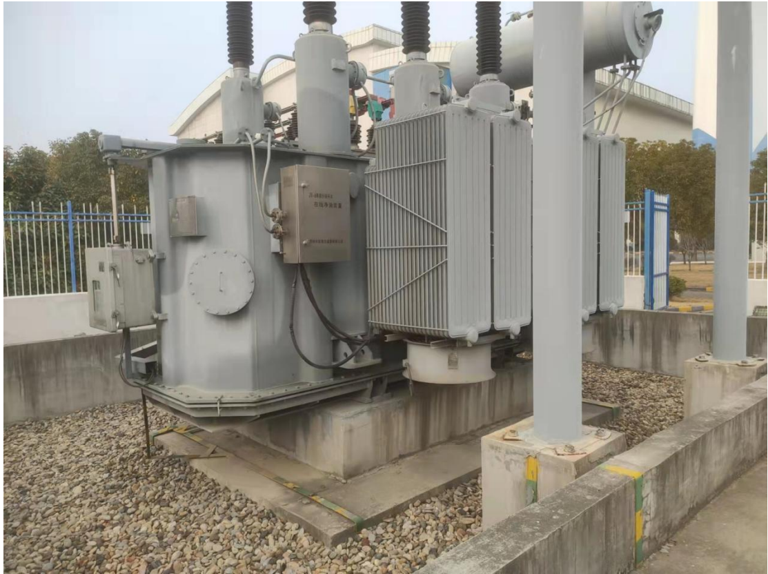
图 1-1 主变压器外观
