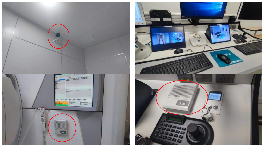
图3-3 加速器机房视频监控和对讲系统
