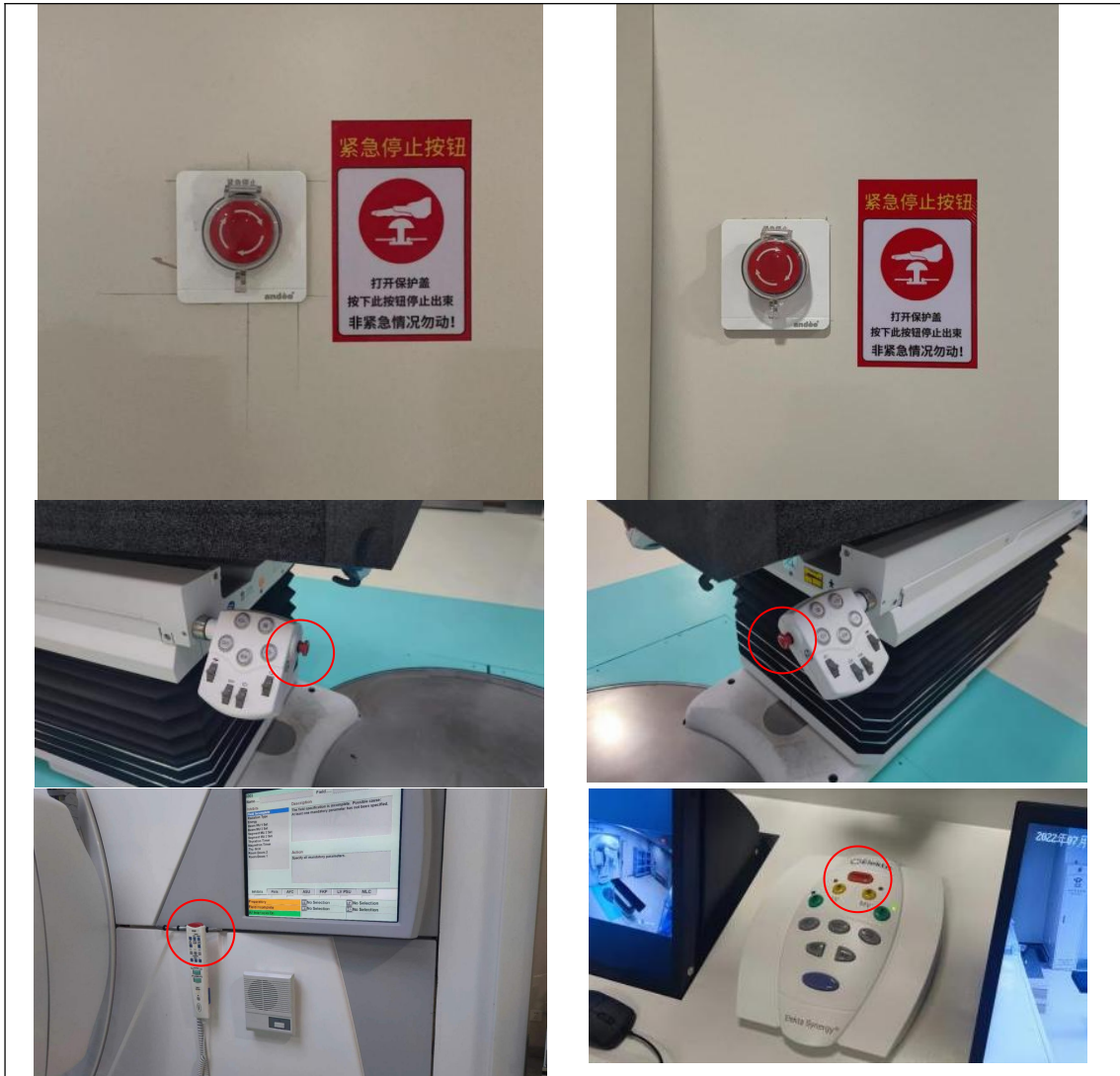
图3-4 加速器治疗室和控制室急停按钮
