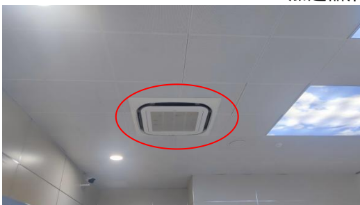
加速器治疗室中央空调
