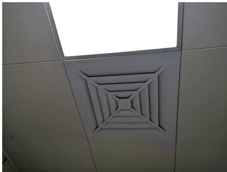
图 4-7 机房内通风装置
