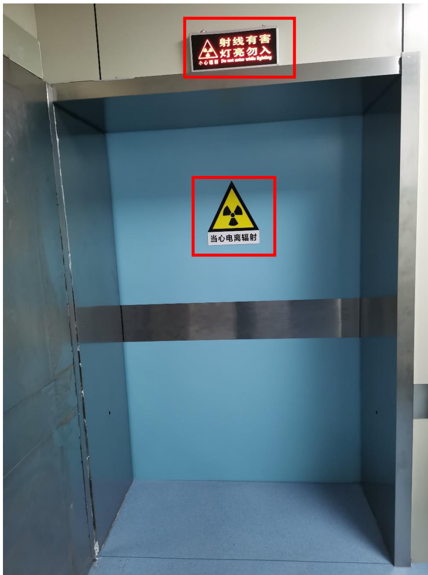
图 4-2 DSA 机房工作状态指示灯和电离辐射警告标志
