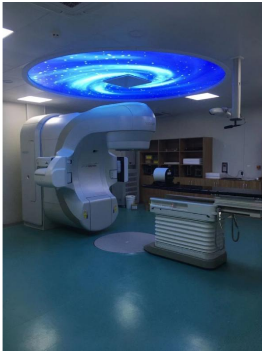
图 2-1 本项目医用直线加速器设备外观图
