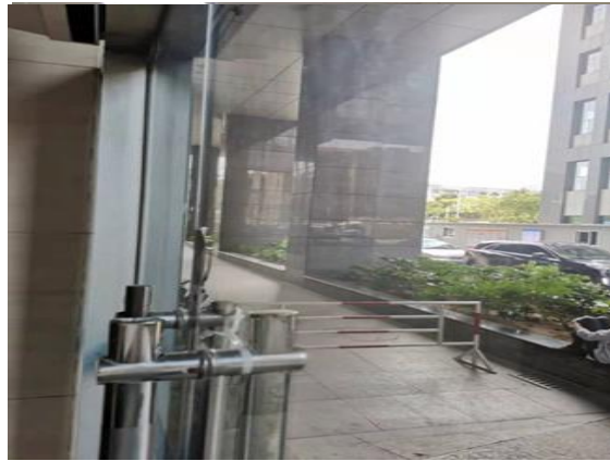
图 3-3-2 城中院区 DSA 机房西侧
