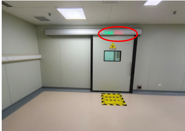
(a) 敌山湾院区导管室 1 机房门
