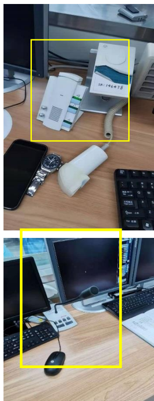
(a) 城中院区 DSA 控制室对讲系统
