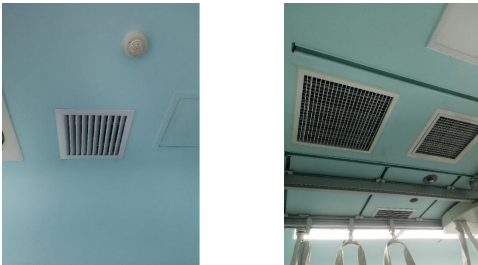
图 4-9 机房内通风装置
