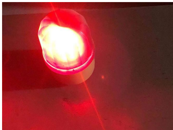
图 4-4 探伤室内警示灯
