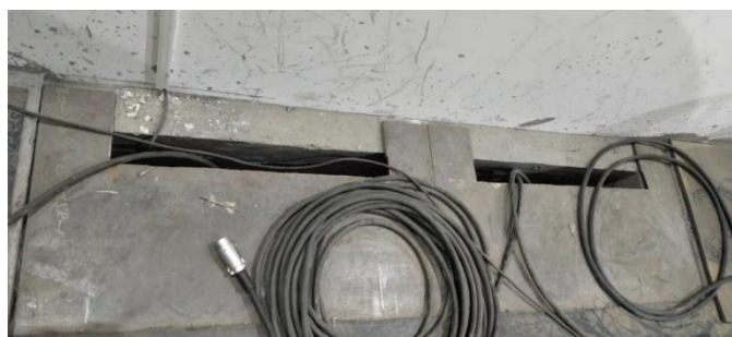
图4-7 电缆管口防护
