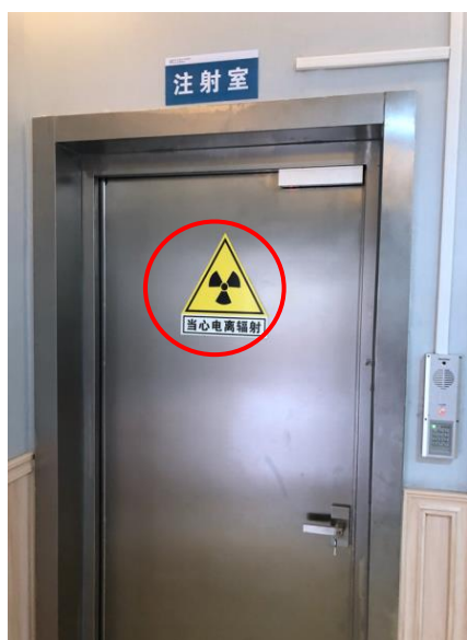
注射室防护门
