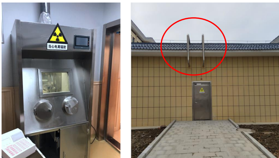
图 4-9 通风橱及排风管道
