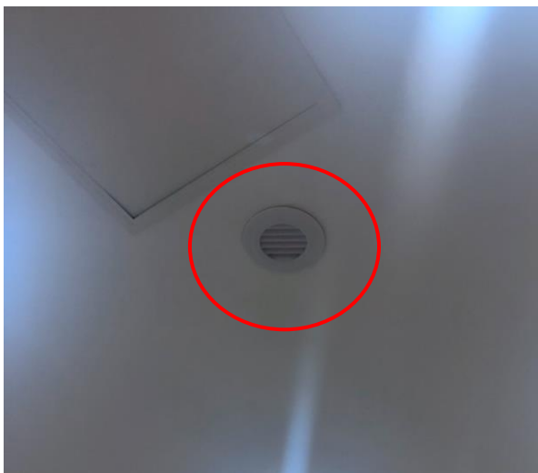
图 4-10 PET/CT 机房内通风装置
