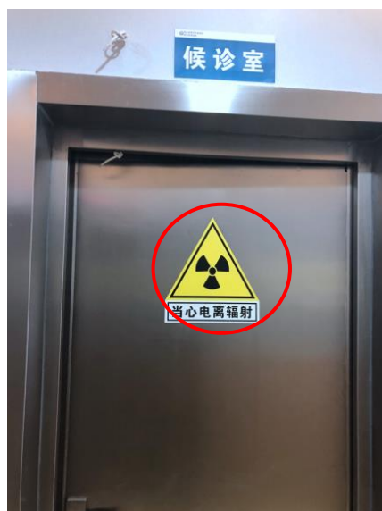
注射后候诊室防护门
