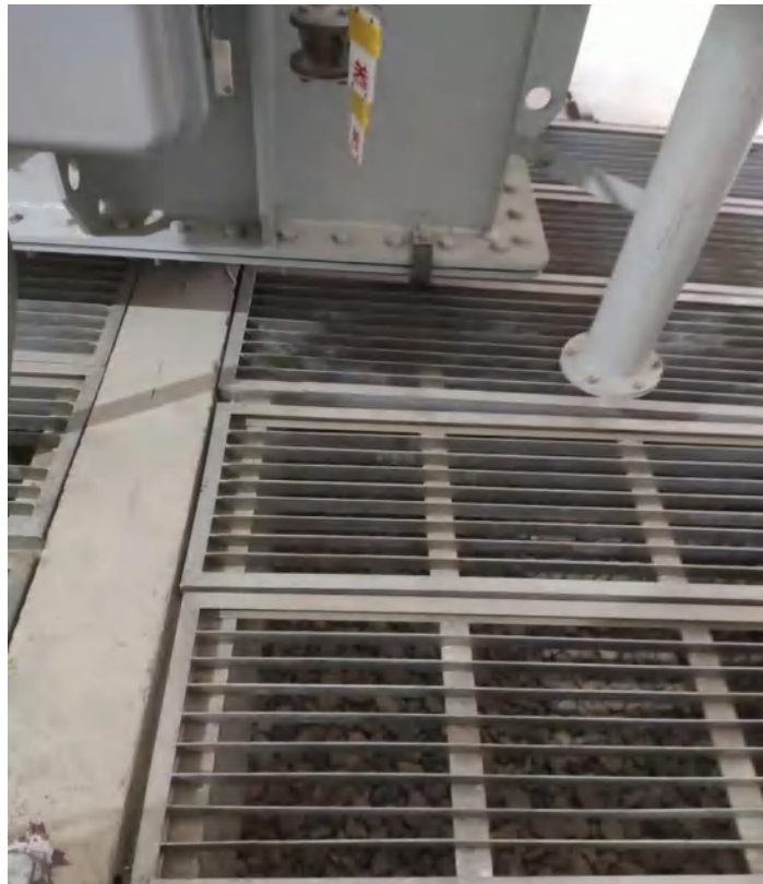
图 8-1 #2 主变下方事故油坑
