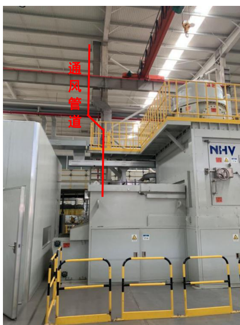
图 4-10 工业辐照加速器通风管道
