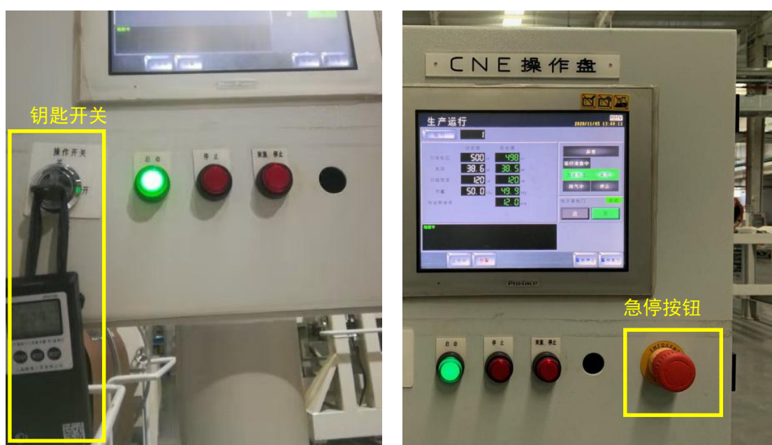
图 4-3 工业辐照加速器控制台上钥匙开关、急停按钮
